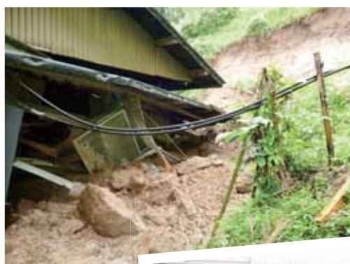
▲ 管内の集中豪雨による被害 （山都町）
