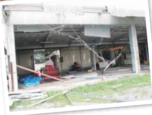
管内の台風による被害（農業倉庫）▶
